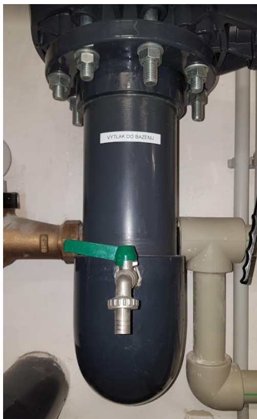
Obr. č. 6 Vzorkovací ventil na přítoku vody do bazénu
