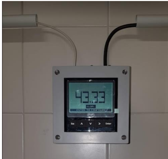
Obr. č. 3 Průtokoměr v recirkulačním okruhu bazény
