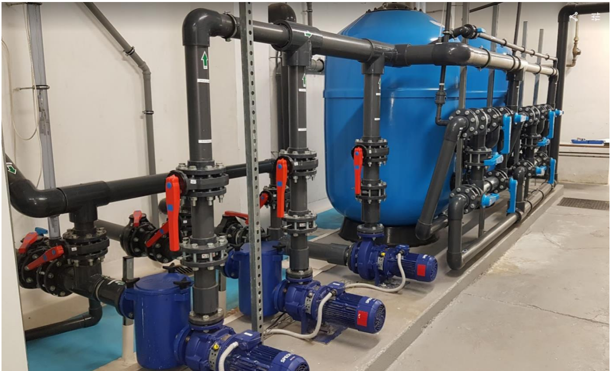
Obr. č. 2 Úpravna bazénové vody
